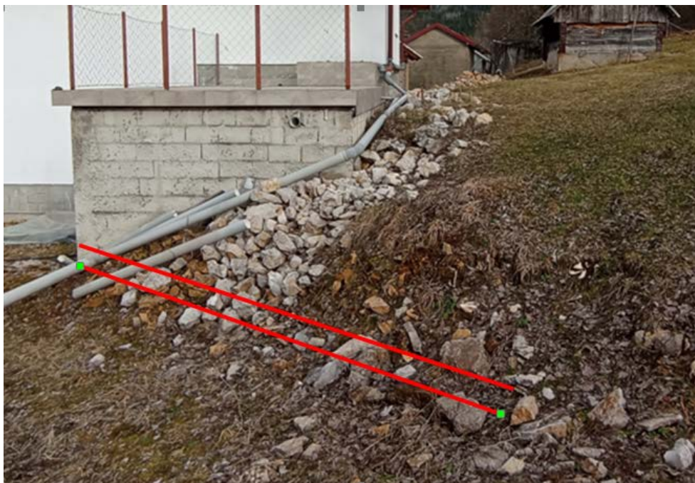
Odvod kišnice – višak vode
