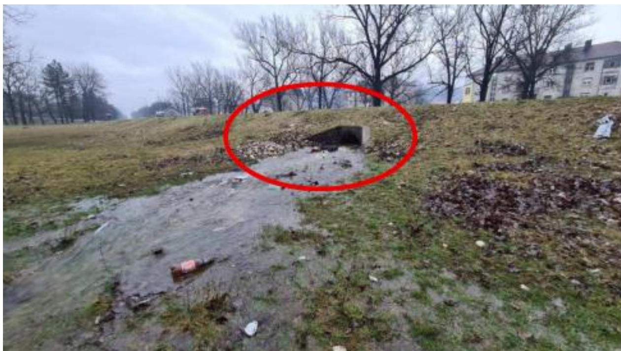
Sl. 3.3. Lokacija u vrijeme obilnih kiša (propust ispod saobraćajnice na južnoj strani lokacije)
