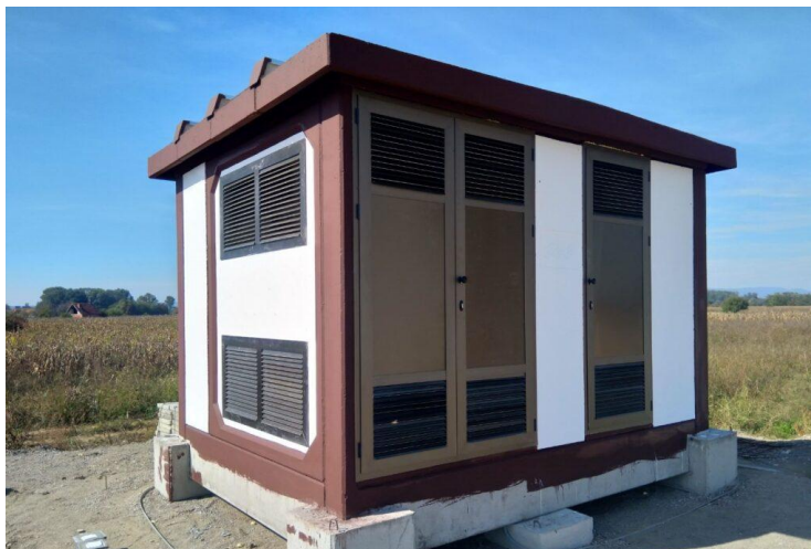
Slika 3-6: TS 10/0,4 kV proizvođača Elektroizgradnja Bajina Bašta
