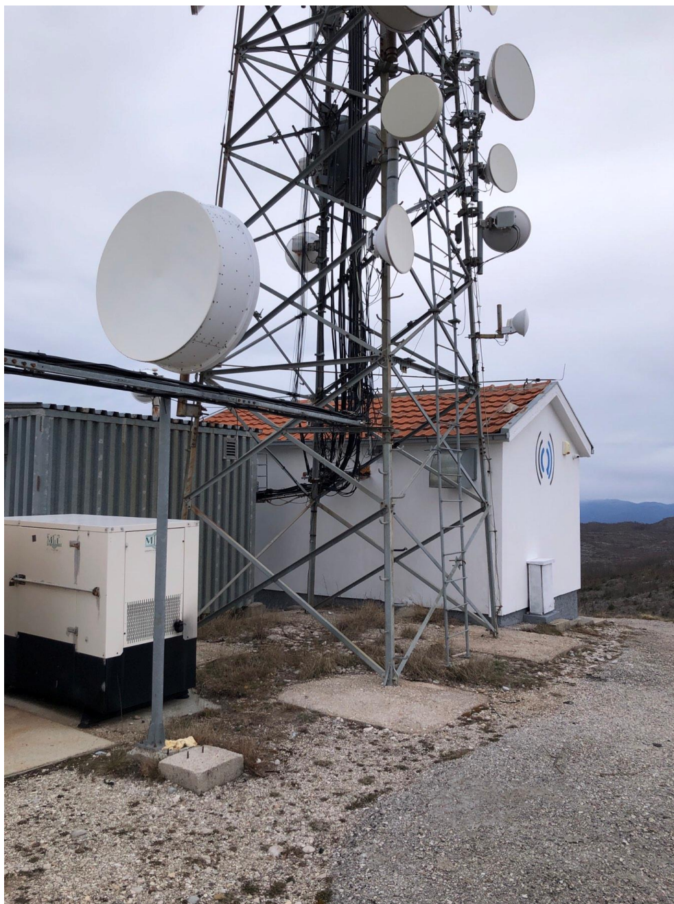
Slika 2. Detalj postojeće radio-difuzne lokacije - stub, antenski sistemi i tehnički objekat
