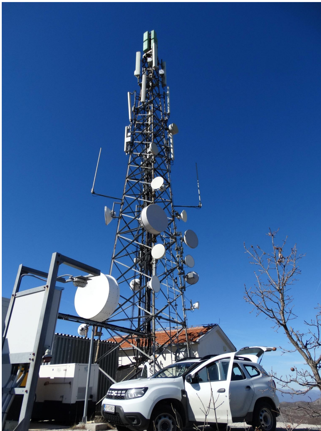
Slika 1. Postojeći telekomunikacioni stub i prateća oprema na lokaciji Ilijino brdo (dostavljena fotografija)
