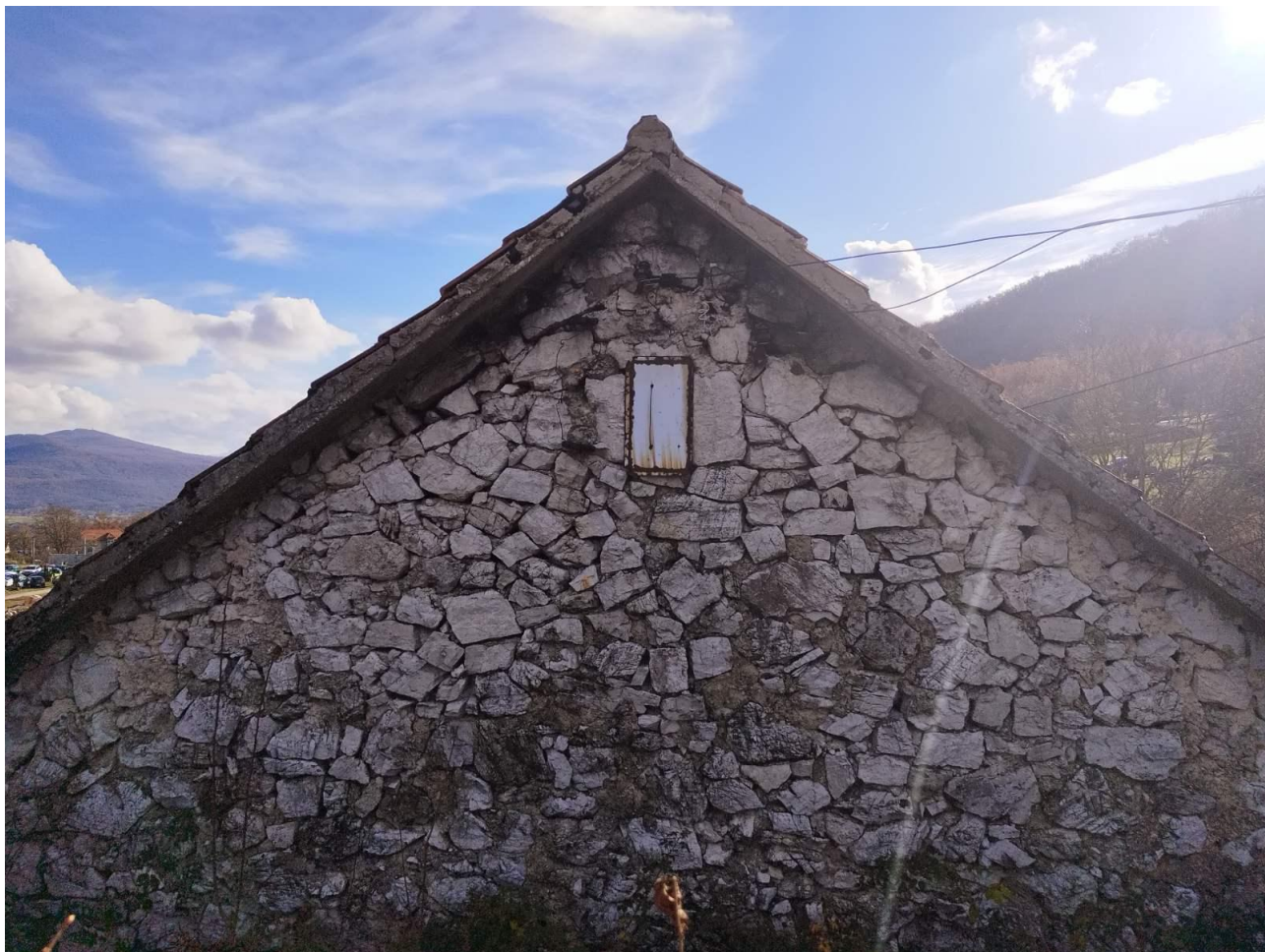
Slika 15: Detalj sjeverne fasade – nepravilno lomljeni kamen vezan krečnim malterom
